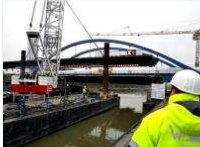
Der Bauleiter blickt zufrieden, das erste Teilstück der alten Brücke hängt endlich am Haken.
